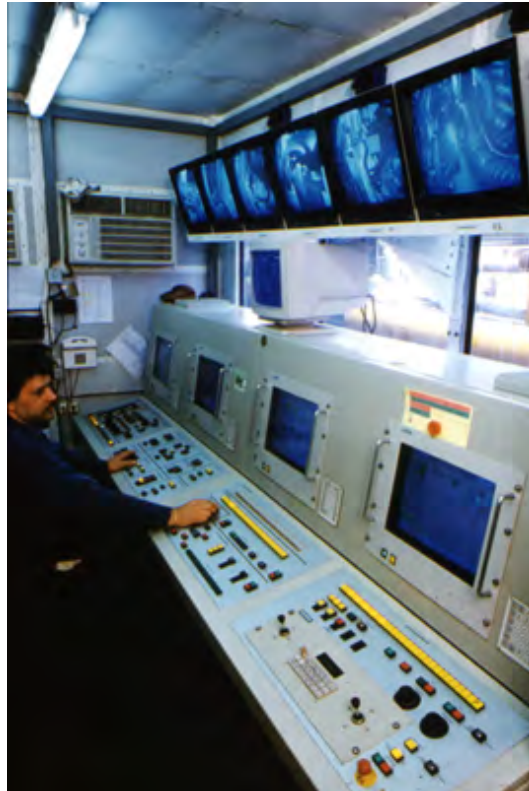
Abbildung 1-1 Blick in den Leitstand einer modernen TBM
